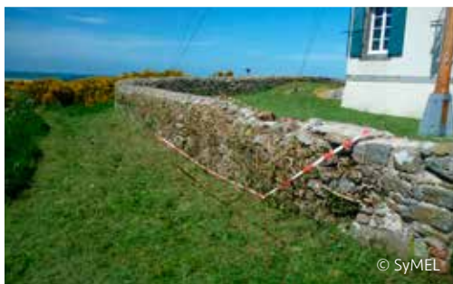
Portion de mur en phase d'effondrement fin 2019
