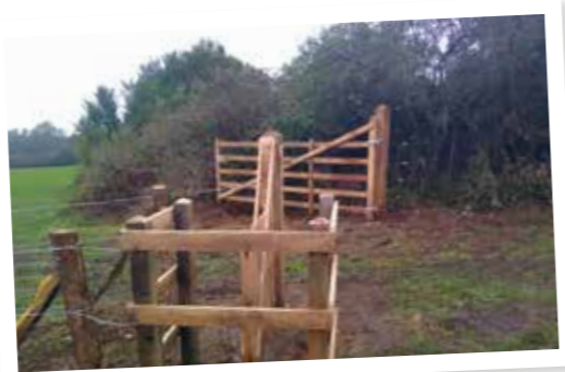
Des équipements en clôture et barrières pour ne pas impacter les agriculteurs, et amener les randonneurs en toute sécurité ont été mis en place.
